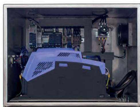
vano quadro elettrico montato su piastra estraibile
